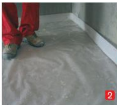
2) Aplikace expandovaného materiálu podél obvodu stěn. Položení vrstvy polyetylenu v případě plovoucího potěru.
